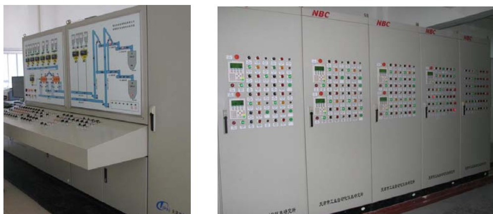
图 2.2 控制室内的配料系统控制柜
